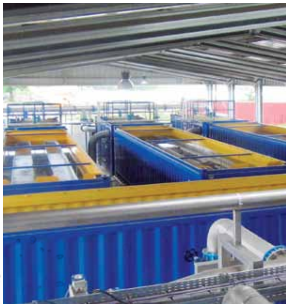
Station de traitement d'eau potable, 750 m 3 /h (Kpong, Ghana)
