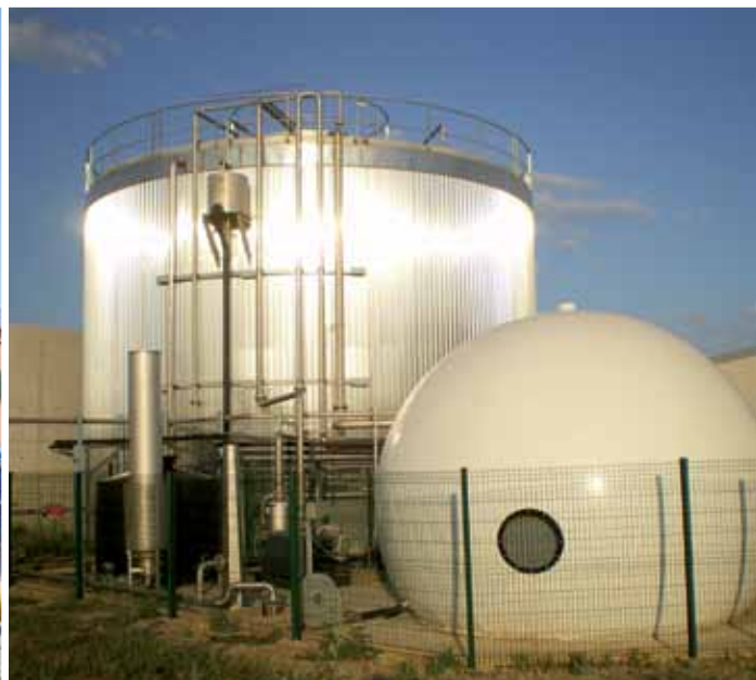
Méthanisation (Casseneuil, France)
