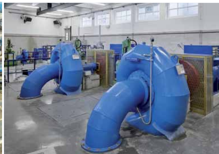
Centrale hydroélectrique (Eupen, Belgique)
