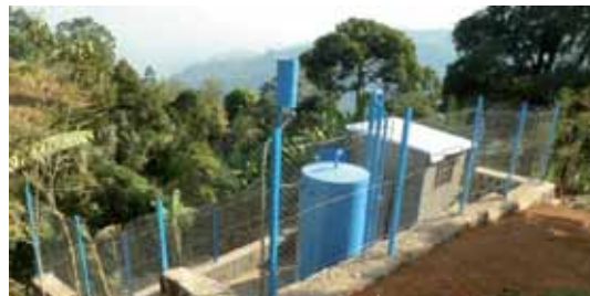
Station de traitement d'eau potable 20 m 3 /h (Jikejemoku, Cameroun)
