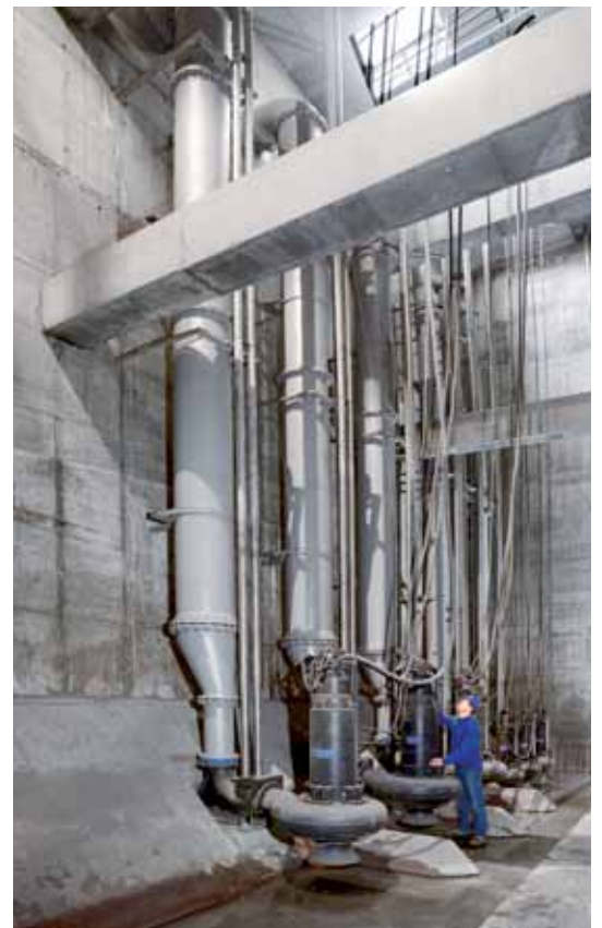
Station de relevage des eaux usées (Ampsin, Belgique)
