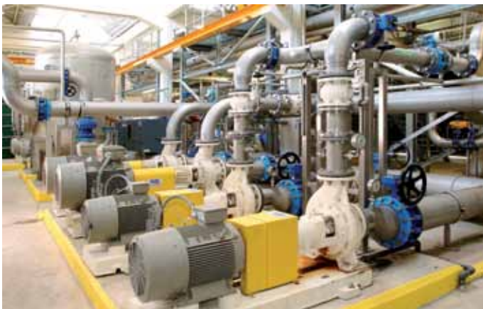
Eau souterraine, 800 m 3 /h (Jambes, Belgique)
